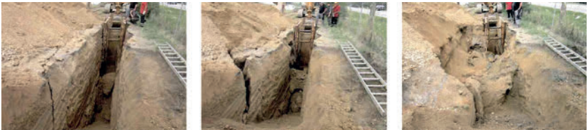
Bild 2: Versagen einer freistehenden Grubenwand auf einer Baustelle (Quelle: Josef Dreier, BG Bau)
