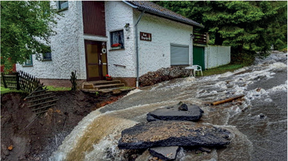
Bild 6: Gebäudeschäden durch einen Gebirgsbach der in sein ursprüngliches Bachbett zurückgekehrt ist (Bild: Archiv der Feuerwehr Clausthal-Zellerfeld).
