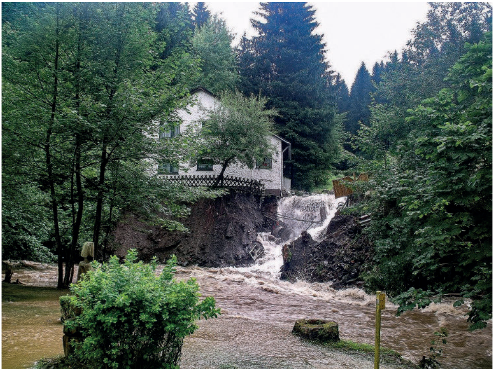
Bild 7: Massive Schäden an den Fundamenten bei diesem Haus waren die Folge eines Sturzbaches (Bild: Archiv der Feuerwehr Clausthal-Zellerfeld)
