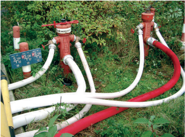
Bild 1: Auf diesem Bild sind zwei Überflurhydranten zu sehen, wovon einer an das öffentliche Trinkwassernetz (links, separat gekennzeichnet) und einer an das werkeigene Wassernetz angeschlossen ist.
